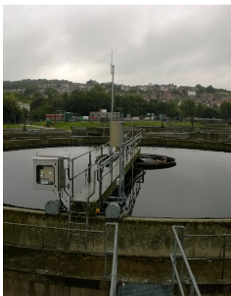
Instalación en una depuradora
